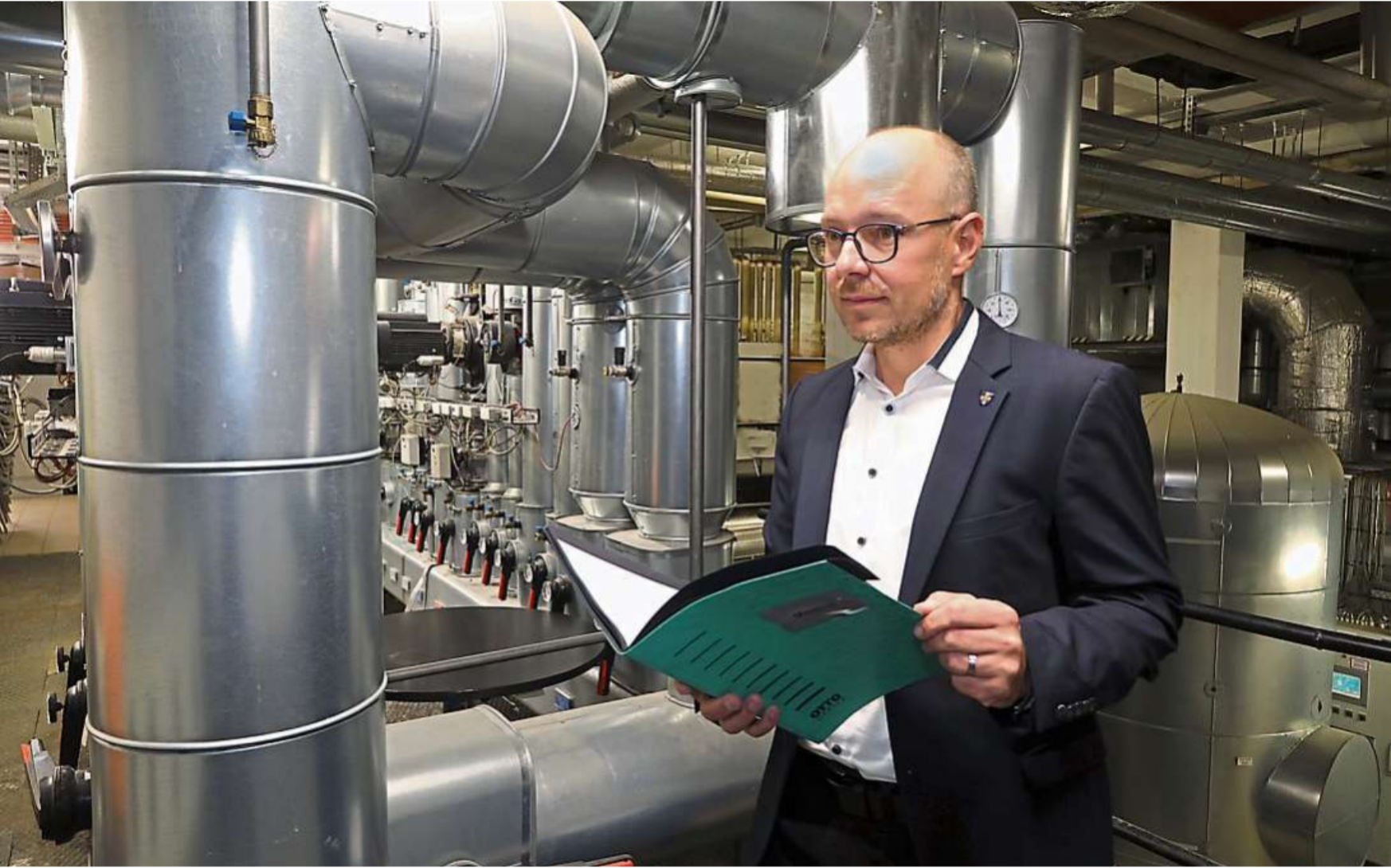
In der Heizzentrale im Keller des Kreiskrankenhauses Weilburg: Wenn Geschäftsführer Thomas Schulz sich die Berechnungen für die Energiekosten anschaut, dann wird er ziemlich nachdenklich. Die stark steigenden Preise für Gas und Strom können die heimischen Kliniken nicht einfach umlegen. Sie brauchen Hilfe. Foto: Jürgen Vetter
